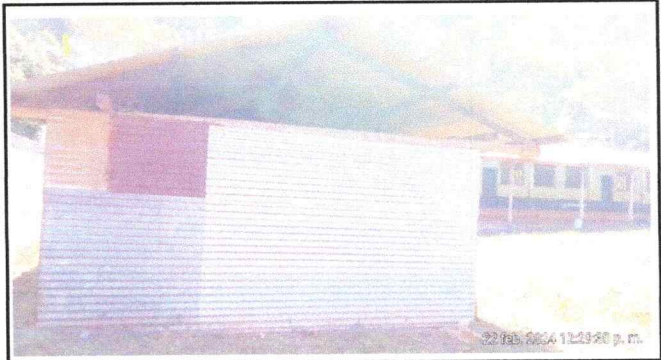
Foto 4: Se Observa el mal estado de las vigas y las paredes del modulo 2
